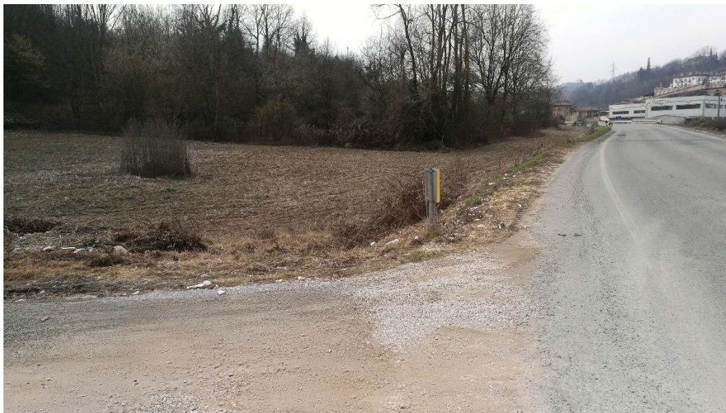
Figura 6 – Versanti posti subito a monte della strada provinciale su cui sarà posata la tubazione. Si apprezza, oltre all'assenza di segni di dissesti, anche la pendenza modesta che inibisce lo sviluppo di dissesti di natura gravitativa
