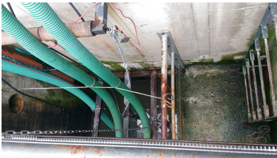
Figura 4: Stazione di sollevamento esistente
