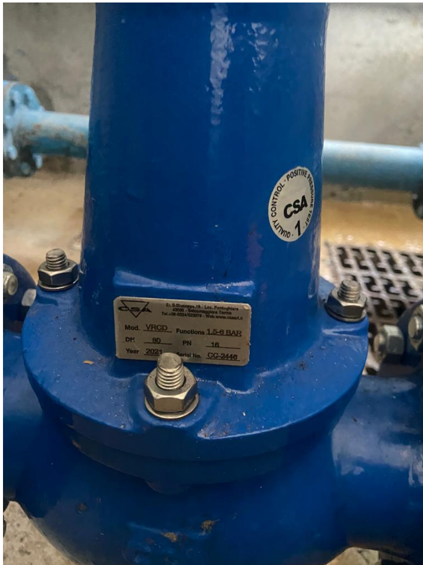
Figura 4 - Riduttore di pressione sito in Via delle Rocche
