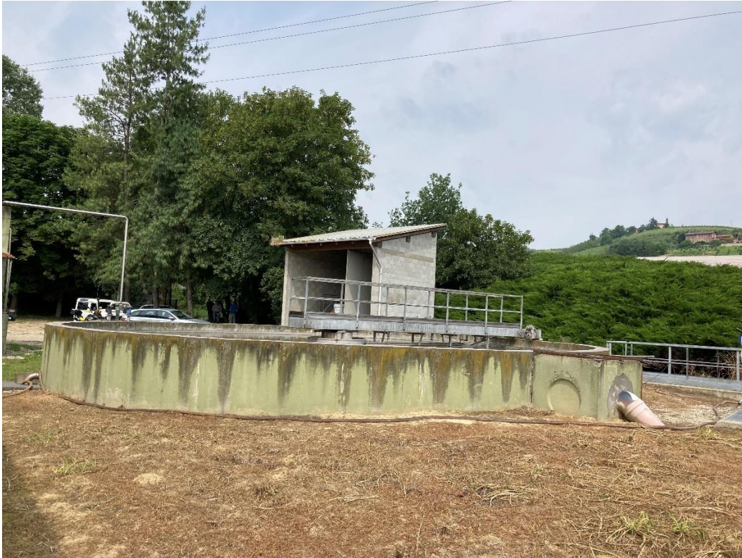
Figura 13 – Impianto di depurazione Canale Valpone: Sedimentatore
