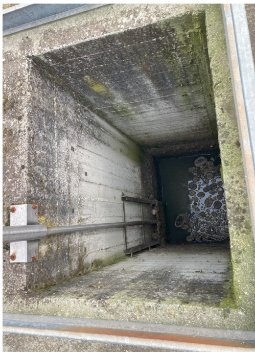
Figura 6 – Pozzo/manufatto ingresso impianto Loc. Cimitero
