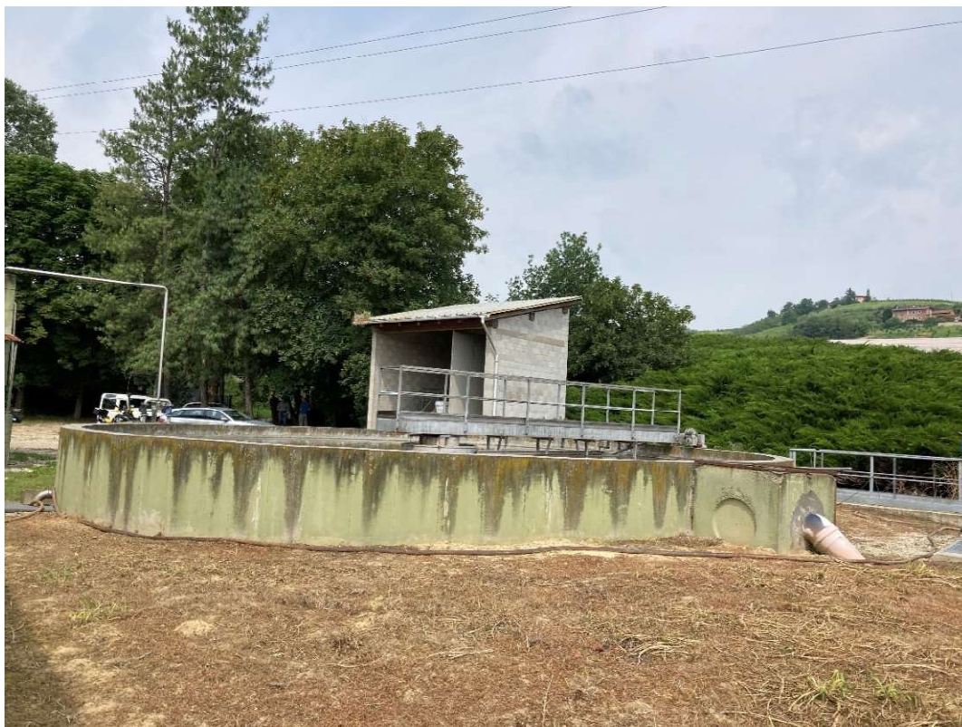
Figura 13 – Impianto di depurazione Canale Valpone: Sedimentatore
