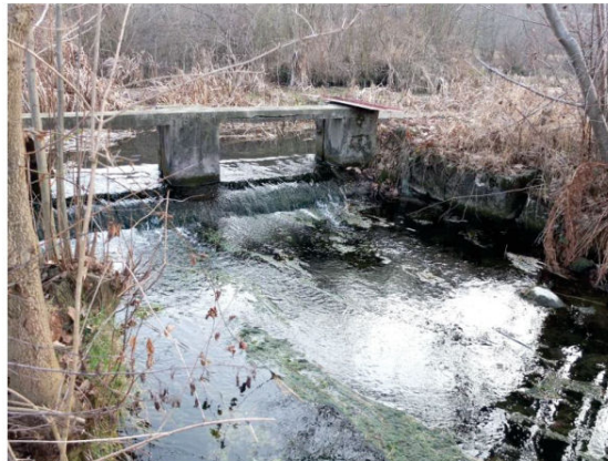
Fig. 6 - Le due bocche a stramazzo che dal bacino idrico convogliano le acque sorgive verso il canale principale
