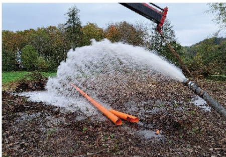
Foto 13: Scarico durante una prova di pompaggio
