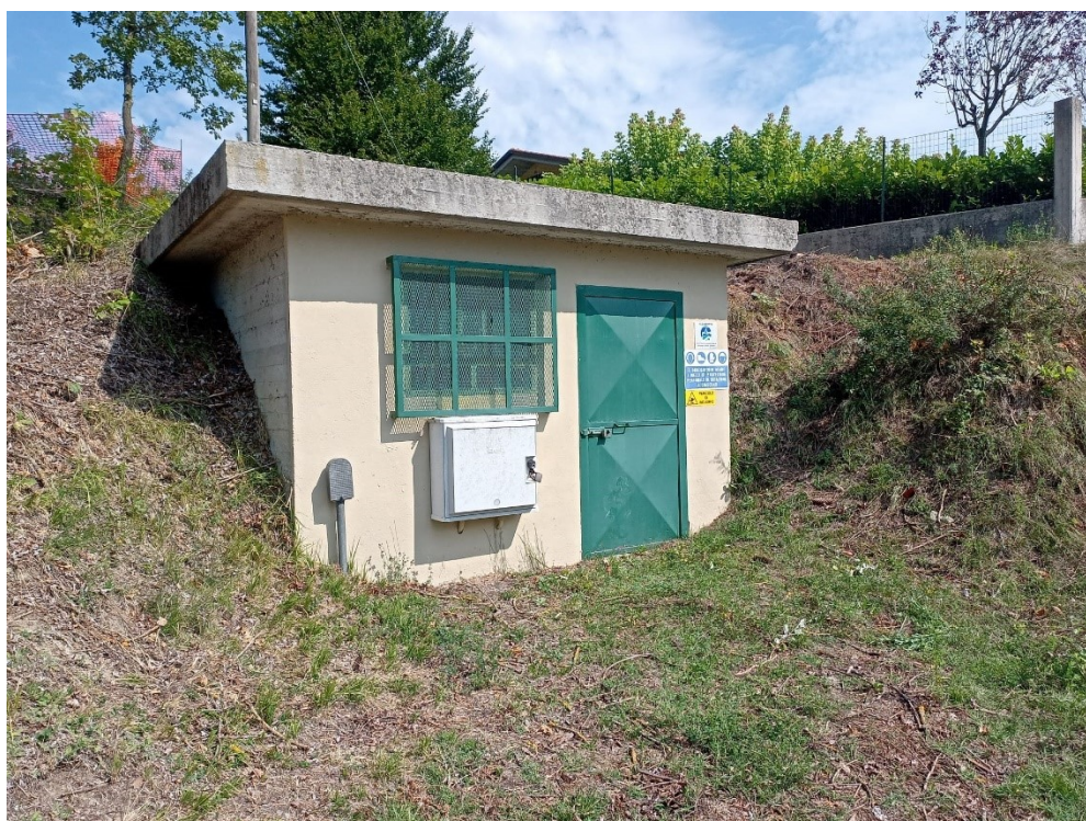
Figura 49 - Cabina di manovra - tipo 2
