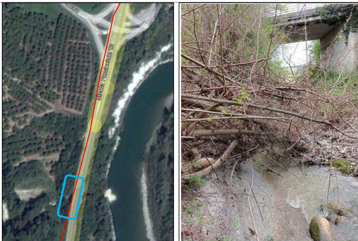
Figura 56: inquadramento su base aereo-fotografica dell'attraversamento del Rio Rivaletto (Lequio Tanaro) e particolare dell'alveo, inciso nei depositi terziari (in basso a sx.) al ponte della S.P. 12
