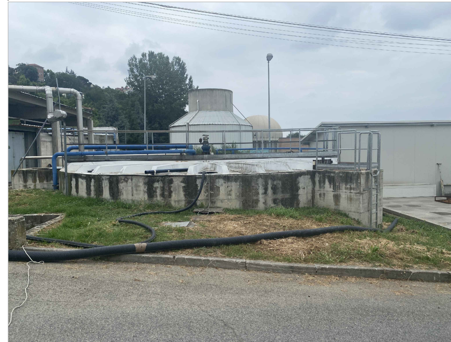
POST ISPESITORE DEI FANGHI ESISTENTE
