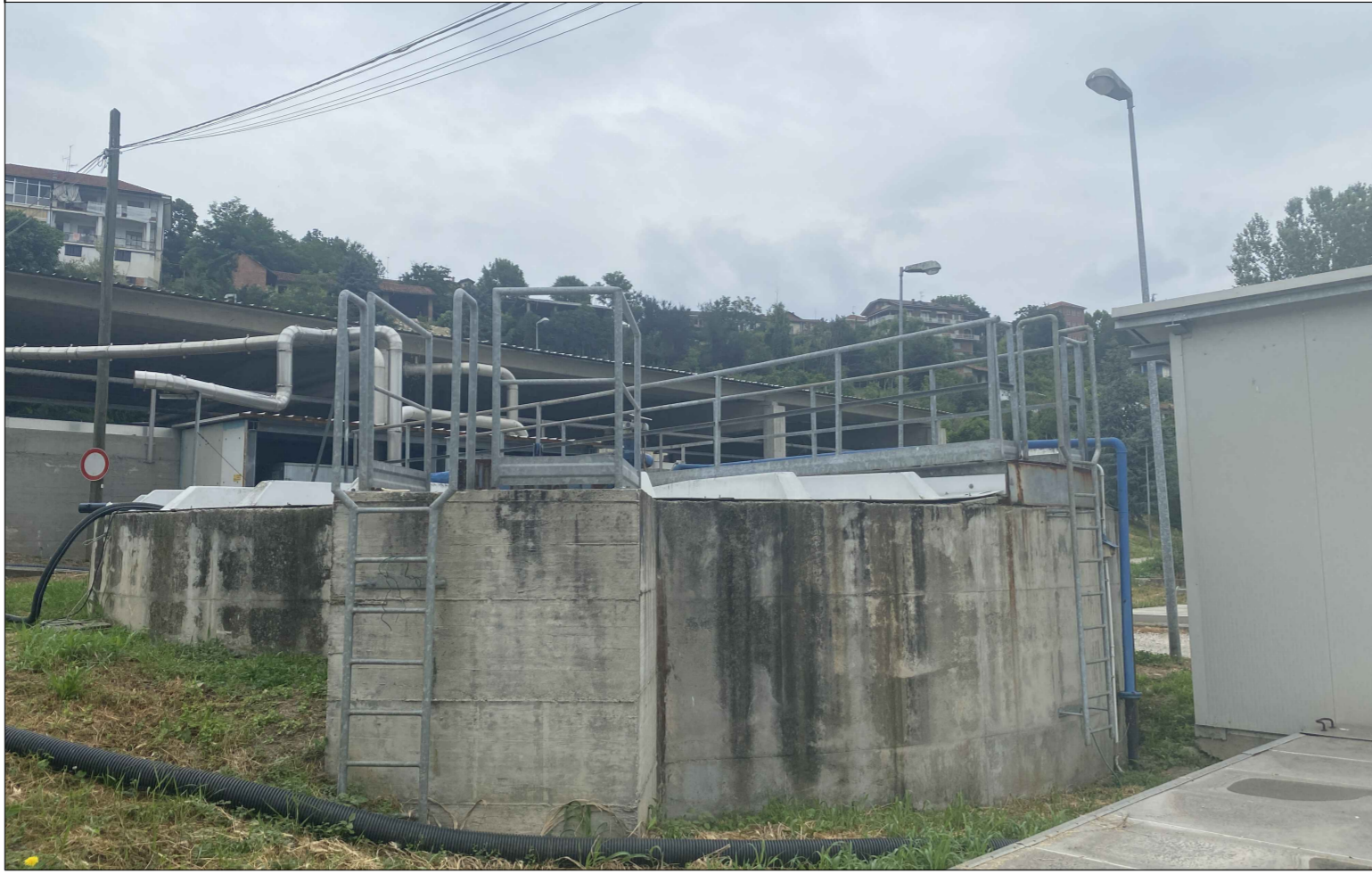
POST ISPESITORE DEI FANGHI ESISTENTE
