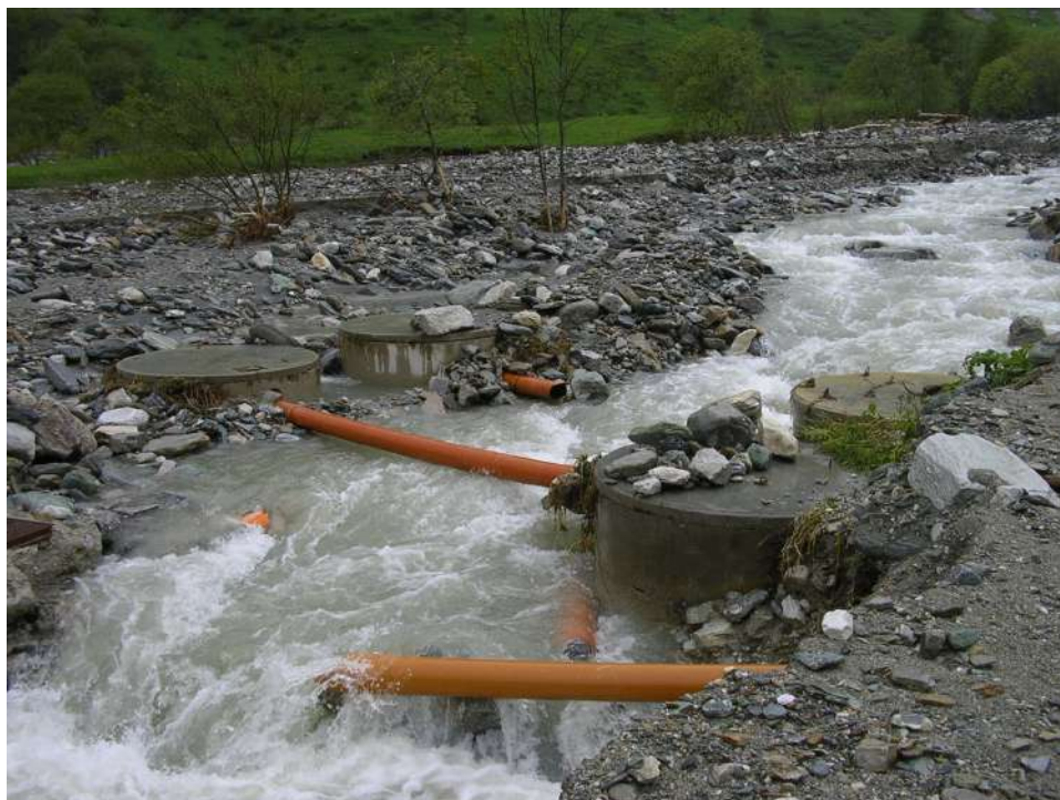
Fig. 5: Vista del depuratore danneggiato dall'alluvione del 2008.
