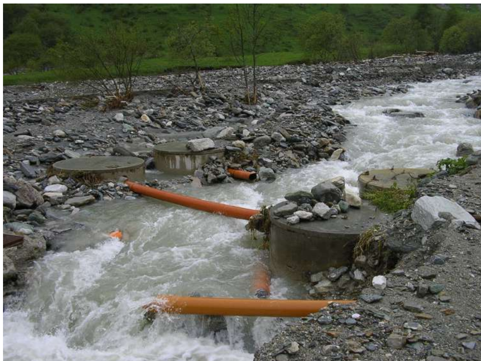
Fig. 5: Vista del depuratore danneggiato dall'alluvione del 2008.
